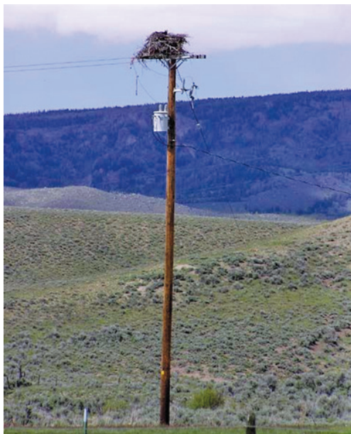
Рис. 4. Гнездо скопы на специальной платформе, установленной на столбе линии электропередач (шт. Вайоминг)
